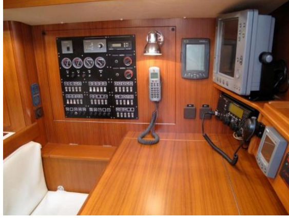
Şekil 2.67. Navigasyon bölümünde elektrik panosu ve elektronikler
