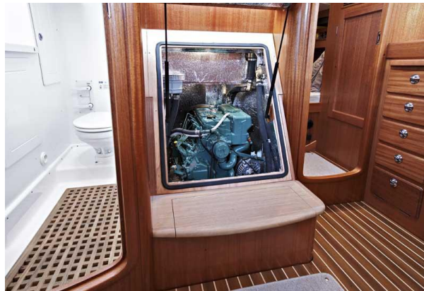
Şekil 3.14. Kabin giriş merdiveni altındaki makine bölümü
