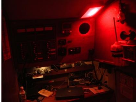
Şekil 2.151. Navigasyon bölümünün kırmızı ışık ile aydınlatması
