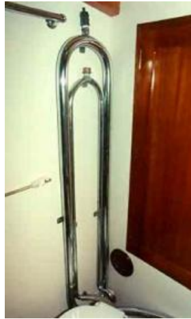
Şekil 2.81. Estetik bir işlevi de olan bir klozet tesisatı
