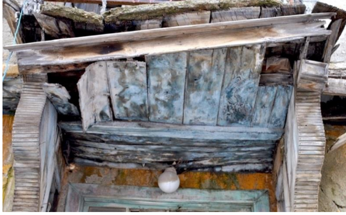
Şekil 2.2: Leke mantarının dış cephedeki renk değişimi ( Kaynak: Betülner Hülagü )
