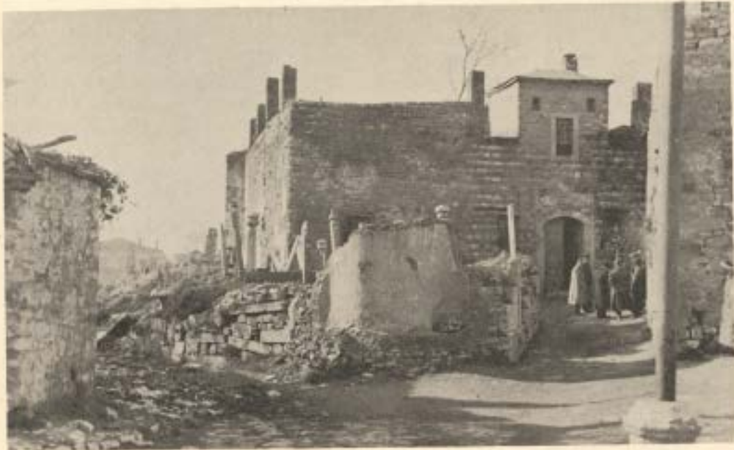
Resim: 9 a - Ankaravî Mehmet Efendi Medresesi, giriş cephesi ve önündeki hazirenin harap durumu (1953)
