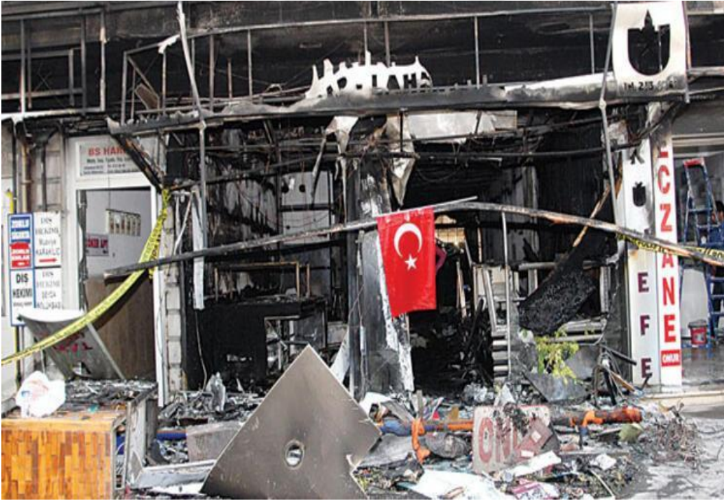
Şekil 5.3. Kırşehir’de linç eylemlerinde hasar gören bir işletme
